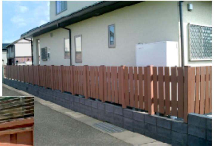
H工事店様施工現場 / 商品種類：M-11N型
